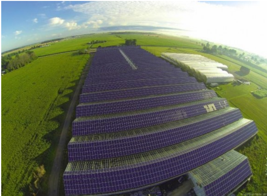
SLIKA 11 - SOLARNE ELEKTRANE - PRIMJER
